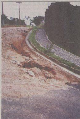
As erosões causam problemas
